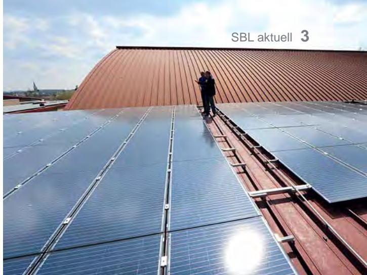
Die PV-Anlage des Sportkomplexes Mozartstraße erwirtschaftet 115.000 kWh
